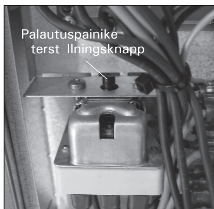
Kuva 3. Ylikuumenemissuoja Bild 3. verhettningskydd
